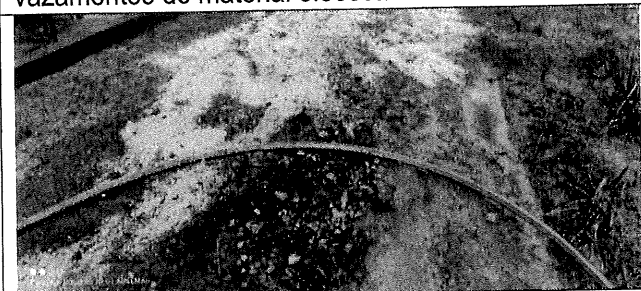
Foto 28 – contaminação de solo próximo a tanques de armazenamento.
