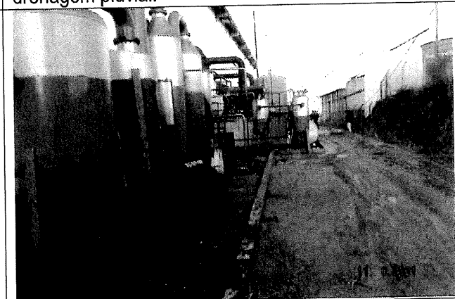
Foto 12 – Situação das contenções e vazamentos.
