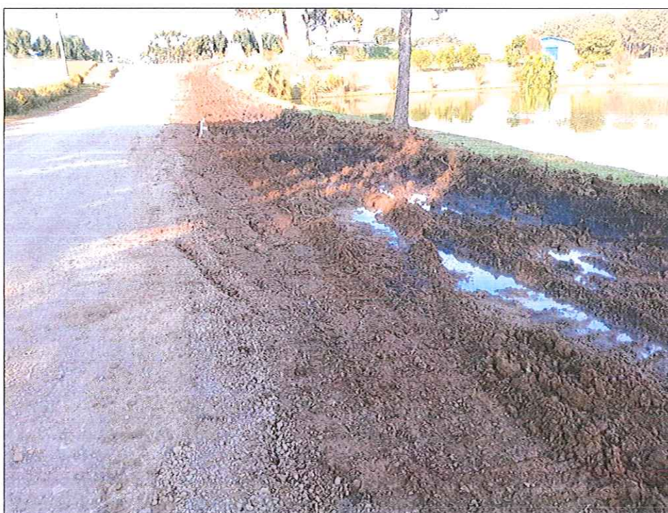
Foto nº. 08- Ocorrência de solo mole e água próximo da estaca 122.
