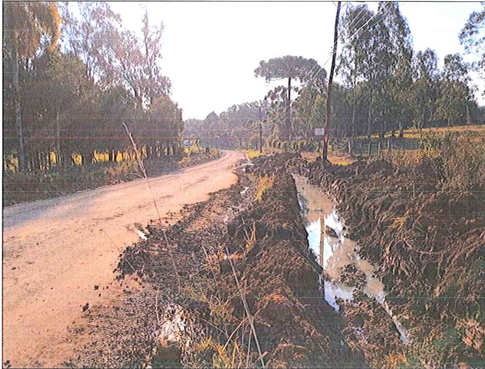
Foto nº. 09- Ocorrência de solo mole e água próximo da estaca 109.
