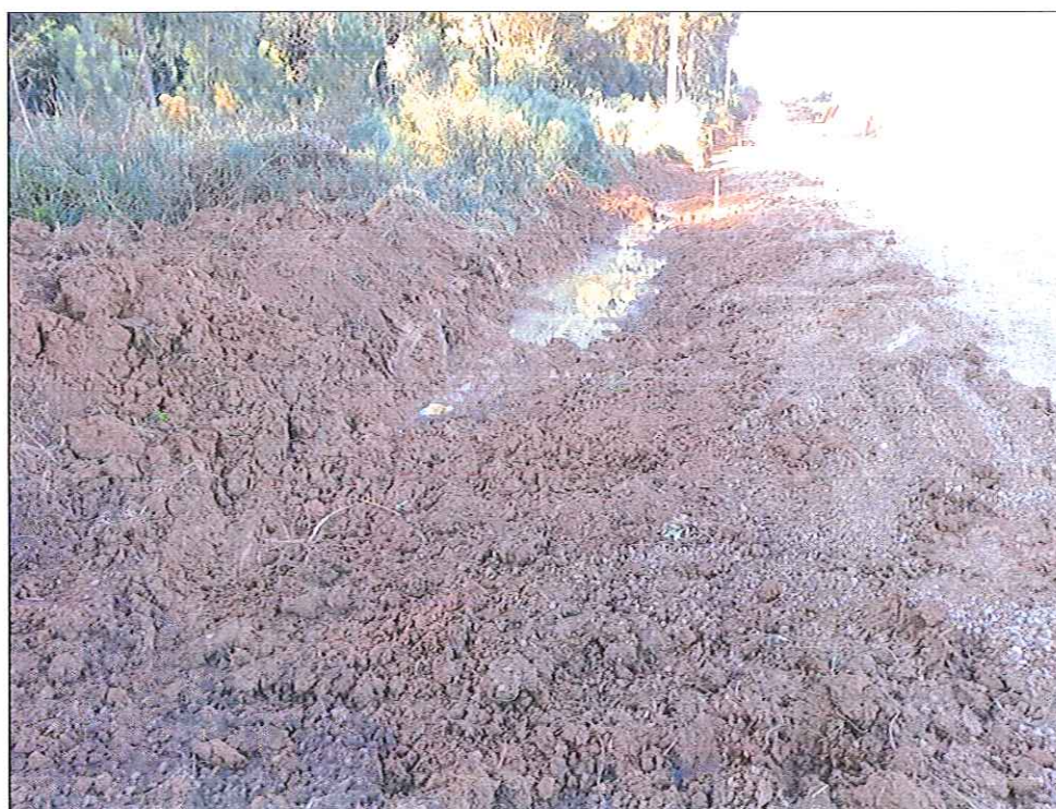
Foto nº. 06- Ocorrência de solo mole e água próximo da estaca 174.
